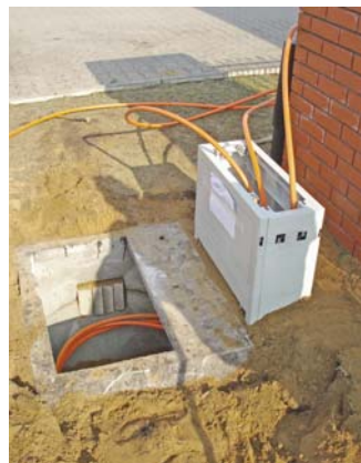
Fot. 13 Zamontowany cokół szafy dystrybucyjnej
