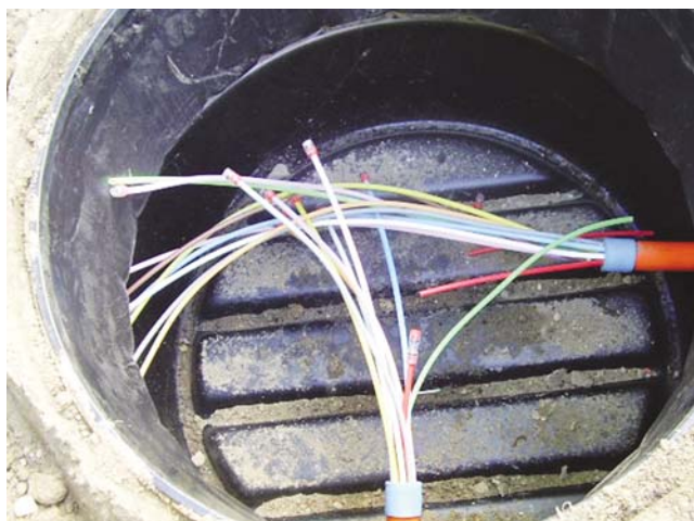
Fot. 8 Studnia KS 80.63/60 zamontowana w sieci światłowodowej zbudowanej na potrzeby monitoringu miejskiego w Radomsku
